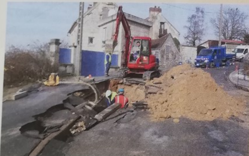
Belle émotion rue du jeu d'Arc après une rupture d'une canalisation d'eau qui a été rapidement réparée
