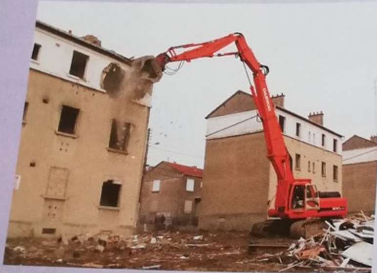
Premiers coups de pelleuse pour la démolition des immeubles. La reconstruction sera achevée fin 2007 en préservant le caractère de cité-jardin et en favorisant la mixité sociale
